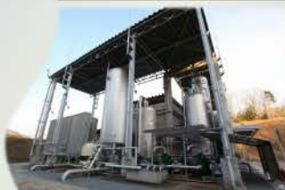
極低温ターボポンプ試験設備
